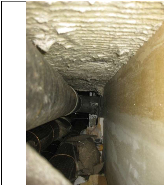
Gennemføringer i nr. 10.1.6 til underliggende lejlighed er ikke tætnet.
