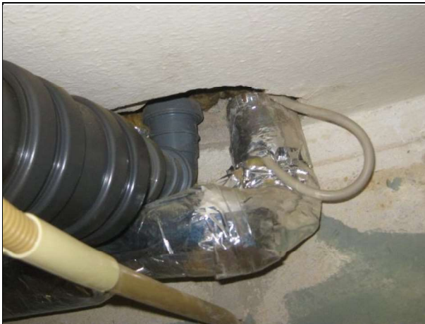
Gennemføringer i nr. 4.1.1 til overliggende HV i baderum er ikke tætnet
