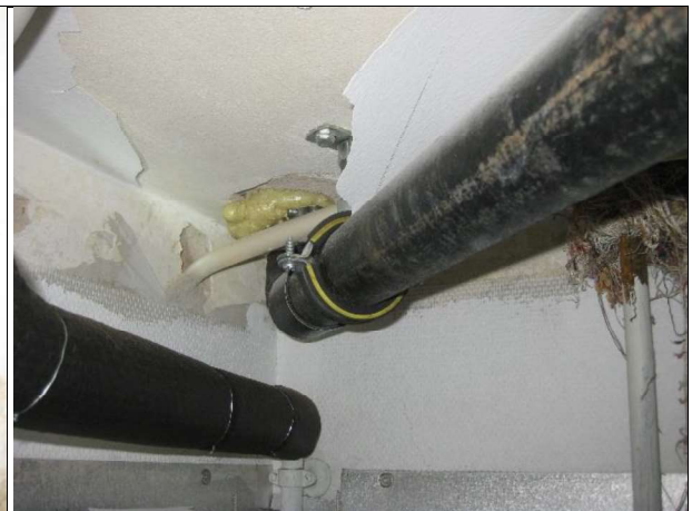
Gennemføring i nr. 10.1.7 til overliggende lejlighed er ikke tætnet korrekt. Rørgennemføring er tætnet med tvist.
