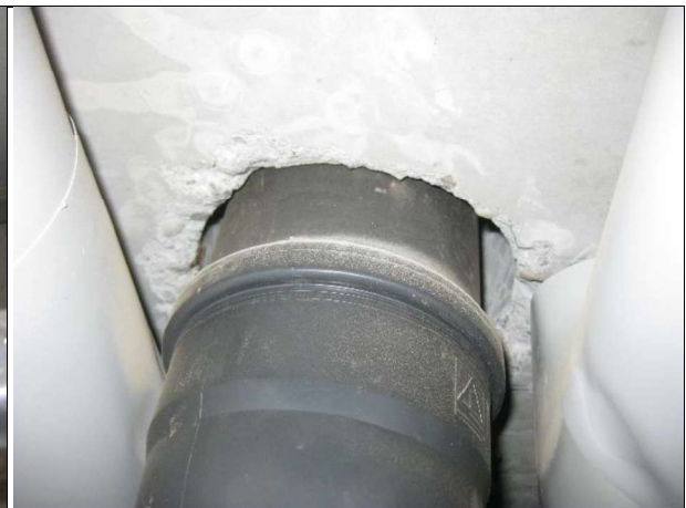
Gennemføring til kælder i boret hul er ikke tætnet, fra lejl. nr. 6.0.4
