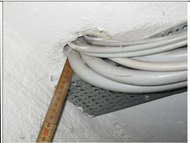
Opføring af kabler fra kælder til stueetage er ikke tætnet
