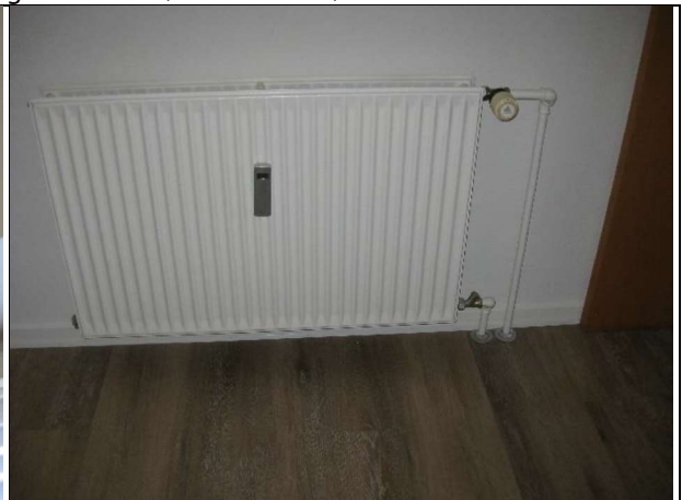
Ny radiator i nr. 4.1.1, forsynet via skjult rørføring i gulvopbygning
