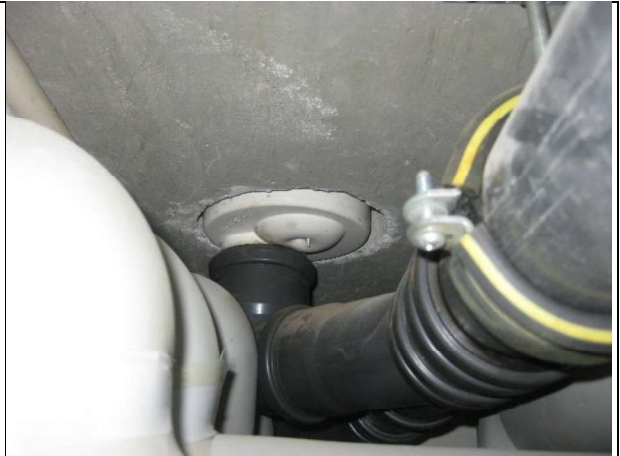
Synlig gulv afløbskål i plast i kælderen - ingen tætning
